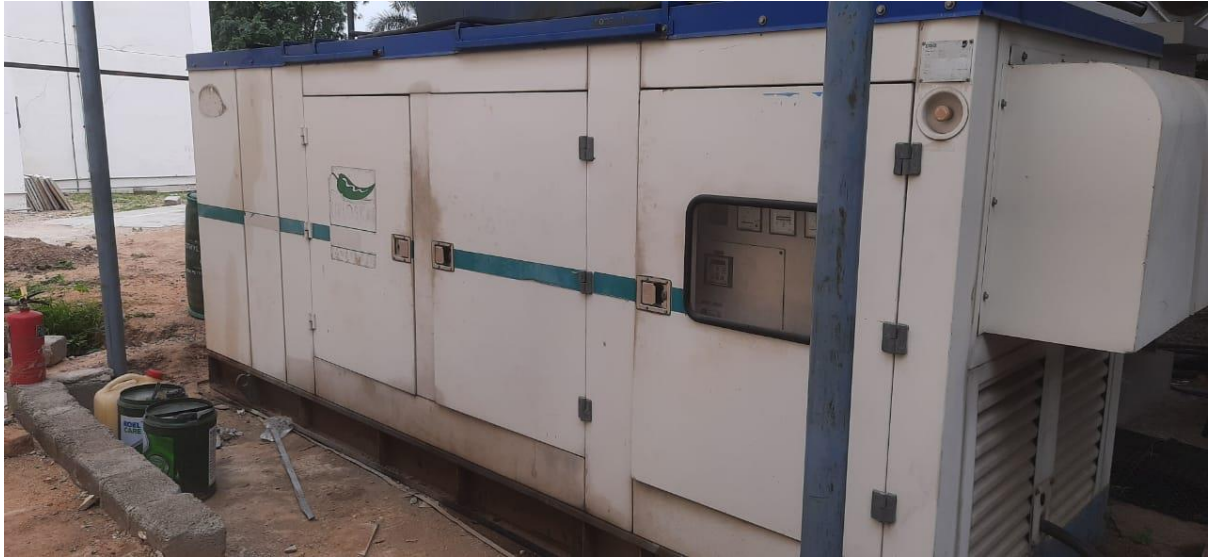
200KVA DG Set
